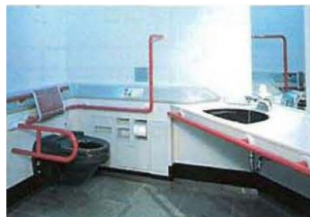
バリアフリーパブリックトイレ
