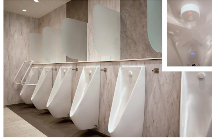
B2棟 1F北西 男性トイレ 小便器コーナー
